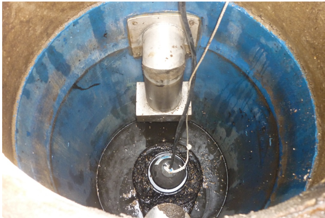
Foto: Afsluiter in afscheiderinstallatie.
