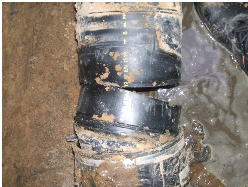
Foto: Lekkage/breuk in leidingwerk.
