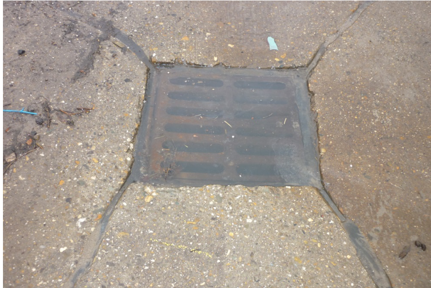
Foto: Ontvangpunt tot bovenzijde gevuld met water.
